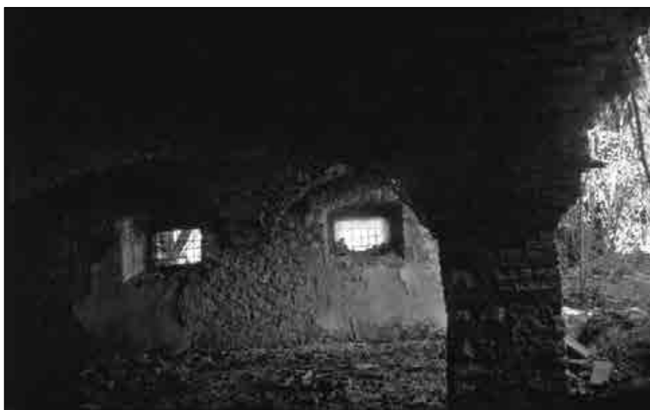
Napol porušene obočne konstrukcije v pritličju severozahodnega gospodarskega trakta gradu Lemberg, preden so se povsem sesule (Igor Sapač, 1999).
