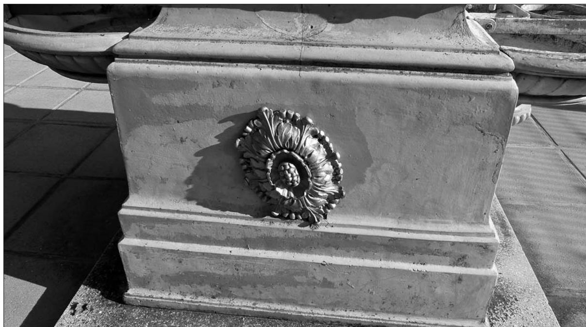
Šmarješke Toplice, detajl s poškodbami na vodnjaku (foto: Simona Kermavnar).
