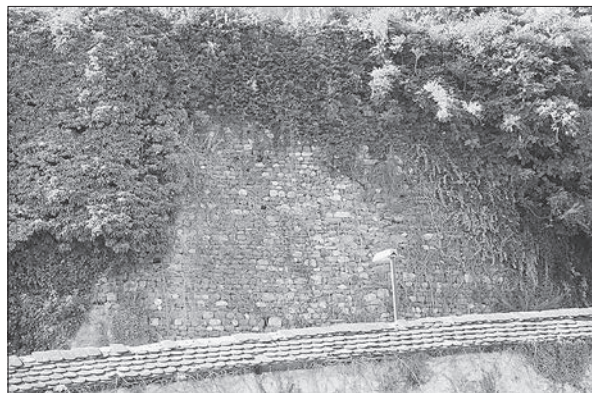
Ostaline srednjeveškega grajskega jedra čakajo na nove raziskave in skrbno sanacijo (foto: Igor Sapač, 2016).
