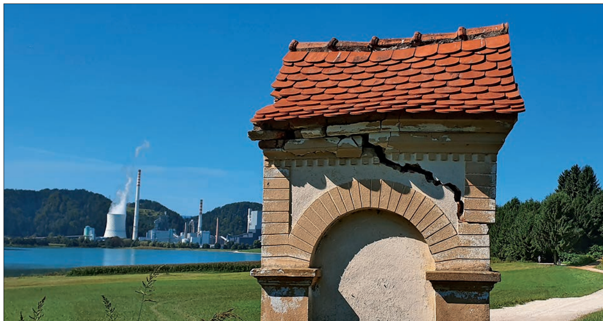
Slika 13: Razpoke na kapelici severno od Družmirskega jezera kot posledica ugrezavanja površja (foto: Matija Zorn, 20. 8. 2021).
